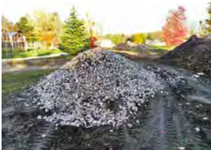
Matériaux de démolition du site réutilisés dans le projet © CD92/T. Garnier Boudier
